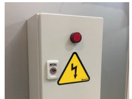
Módulo de control
